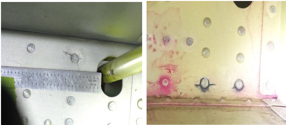
FIGURA 1: TRINCAS NO BORDO DE FUGA
