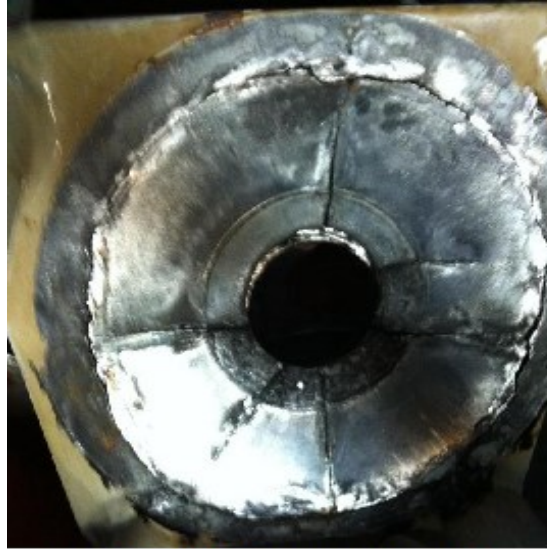
Exemplo de WD-1001E severamente danificado.
