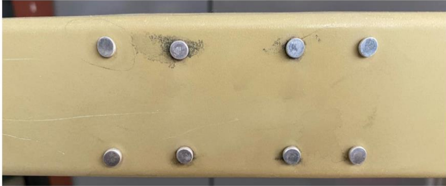
Figura 3 - Localização da trinca - Vista dianteira da longarina
