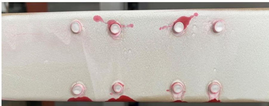
Figura 4 - Localização da trinca - Vista dianteira da longarina
