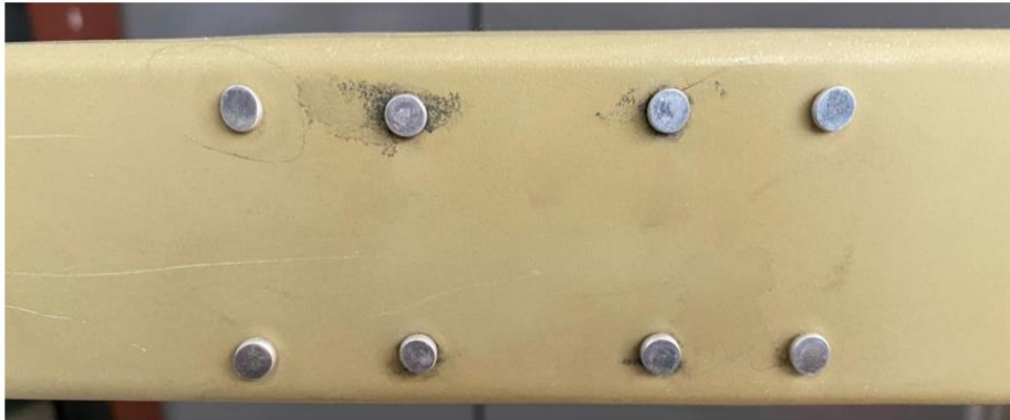
Figura 3 - Localização da trinca - Vista dianteira da longarina
